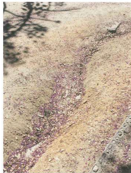
Κακόμορφο «νεροφάγωμα» τῆς ἐπιφανείας δρομίσκου τοῦ κήπου.
